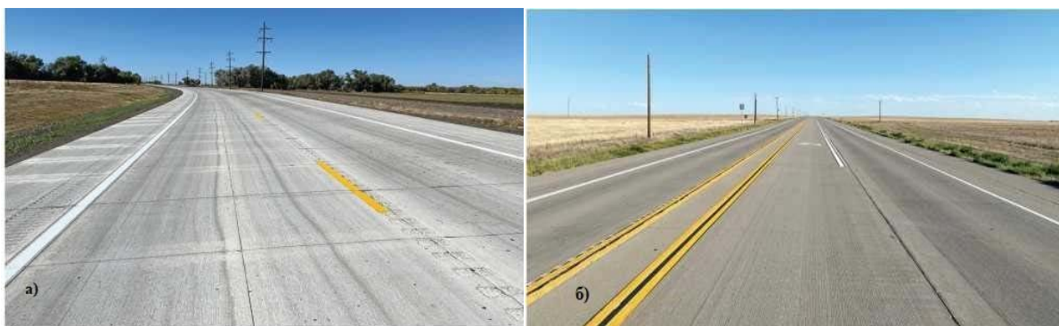
Фиг.1. Изглед на свързано а) и несвързано б) бетонно пренастилане върху съществуваща асфалтова настилка [6]
