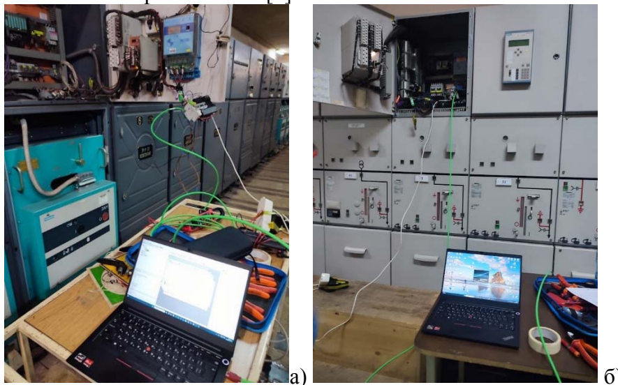
Фиг. 1. а,б. Общ вид на измервателната постановка в ТПС на МС „Западен парк“ и МС „Стадион Васил Левски“
