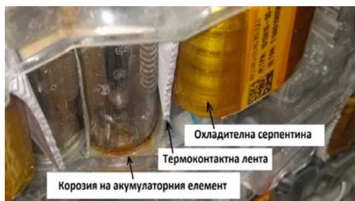
Фиг. 4. Корозия на акумулаторния елемент от изтичане на охлаждаща течност поради пробив на серпентината
