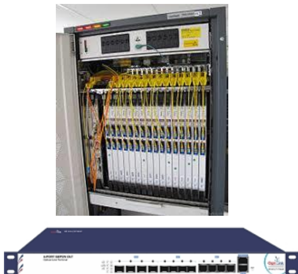
Фиг.1а OLT оборудване
