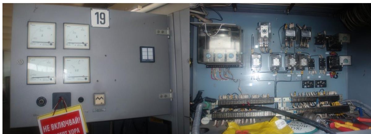
Фиг. 2 Оборудване на килия № 19 в ЗРУ
