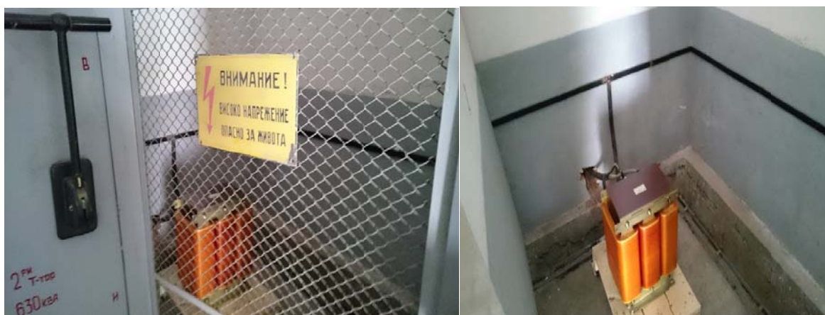
Фиг. 5 Външен изглед на монтирания реактор
