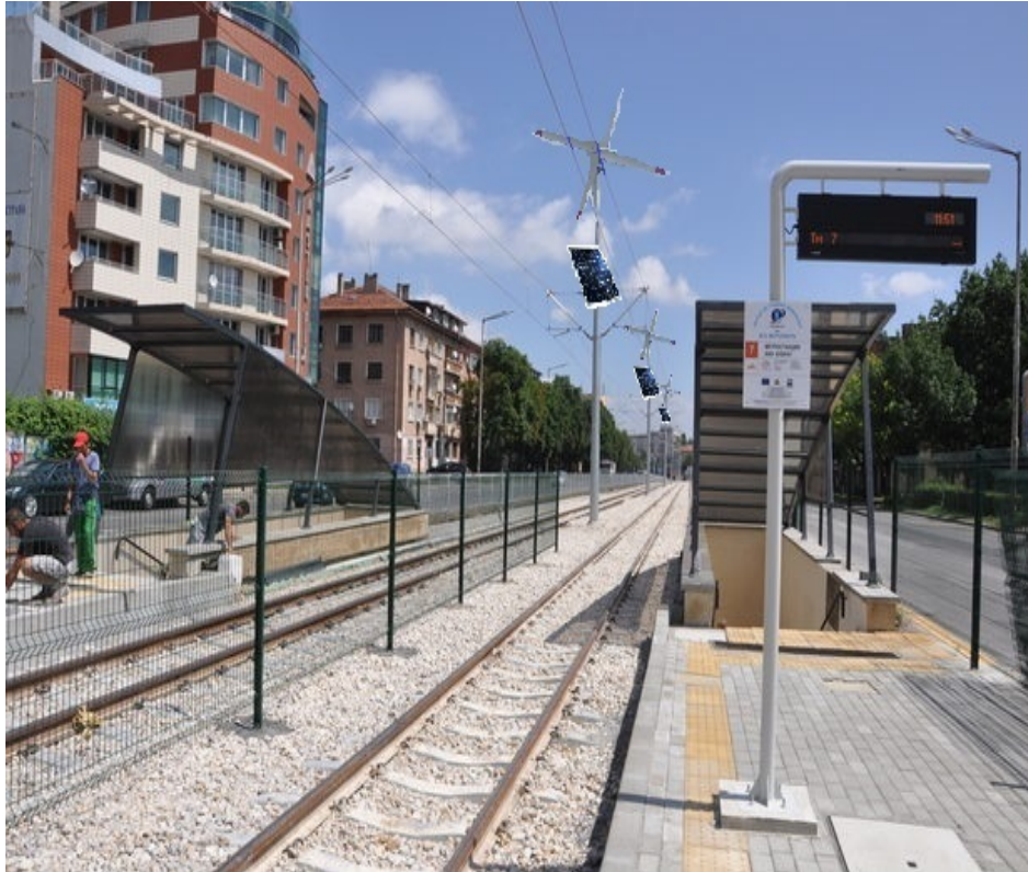
Фиг. 4. Изглед на контактната мрежа за градски електротранспорт като възобновяем енергиен източник.
